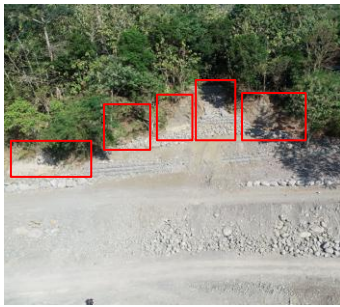
Gambar 4. Tebing yang longsor di sekitar IUP PT A relatif luas dan parah, ditangani tidak maksimal (Sumber: Foto Udara 1 September 2023)
