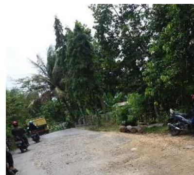
Gambar 6. Amblesan di Jalan Raya
