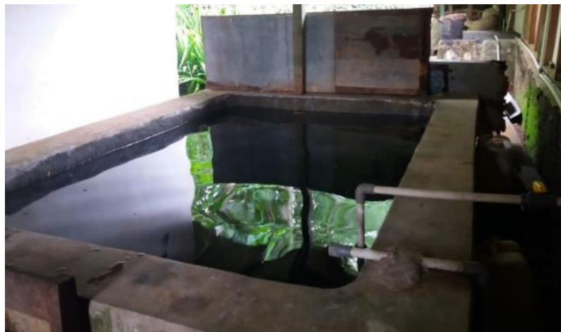
Gambar 2. Kondisi Penampungan Air Hujan
